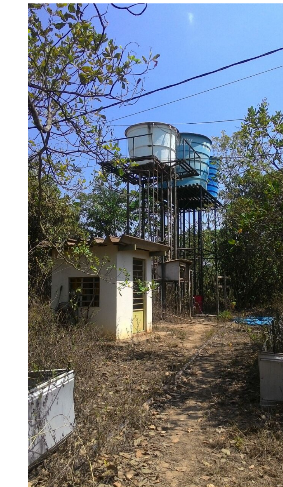
(1) Abastecimento de água
