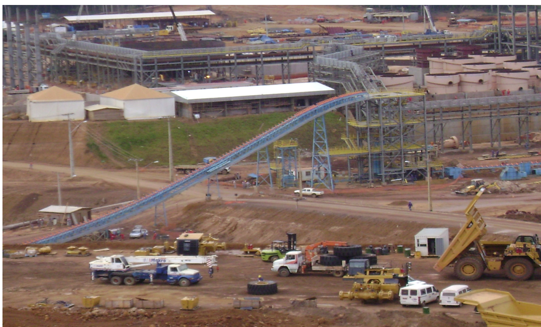
Figura 26 – Planta de Beneficiamento de minério de ferro da empresa Anglo Ferrous Brazil
