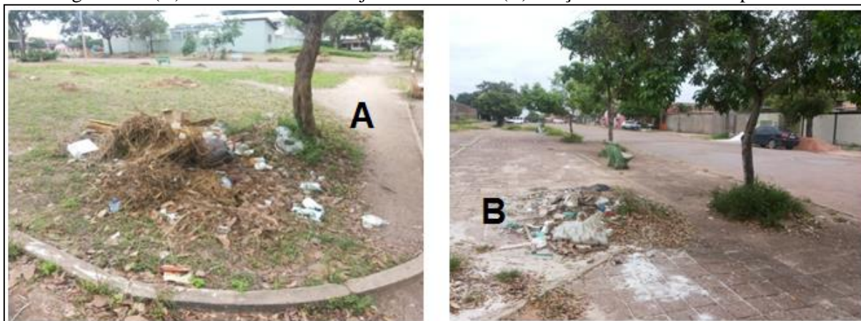
Figura 34 - (A) Bocas de Lobo e Sarjetas obstruídas. (B) Calçamentos obstruídos pelo lixo
