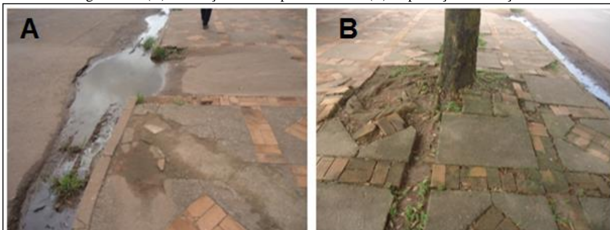
Figura 31 – (A) Obstrução das rampas de acesso. (B) Depredação das calçadas
