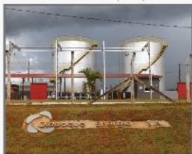
•Foto 6: Rede de eletricidade em Oiapoque
