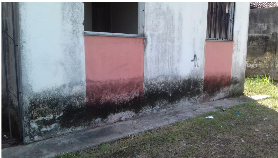
Figura 17 - Infiltração em um bloco do Conjunto Mucajá.
